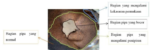
Gambar 5 Penampakan Kebocoran dari Dalam Pipa
