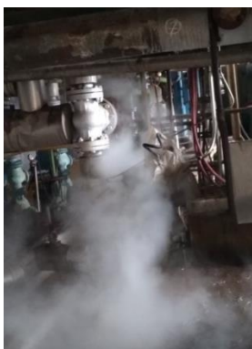
Gambar 4 Kebocoran pada Pipa
